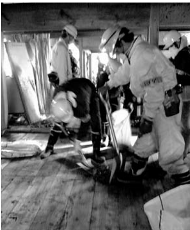
勿来被災住居の泥出し作業
